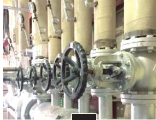
■蒸気配管器類
