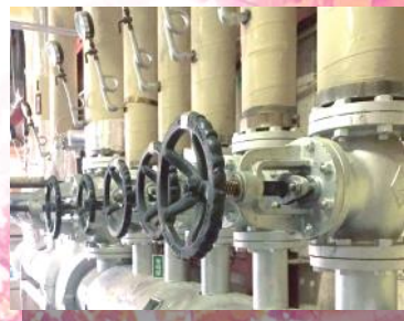
■蒸気配管器類
