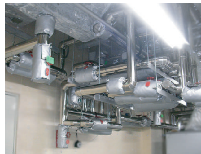
クリーンルーム内蒸気配管
