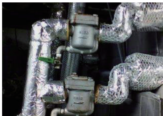
えこきーぱー施工前
