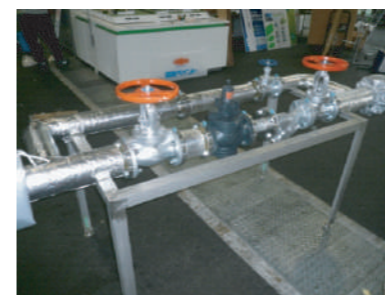
えこきーぱー施工前
